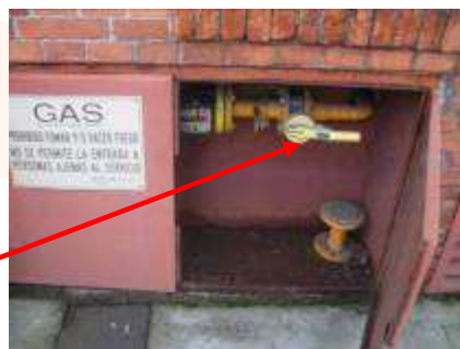
Acometida de gas
